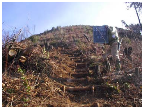
間伐材を利用して、植樹会場の歩道に階段を設置しました。
